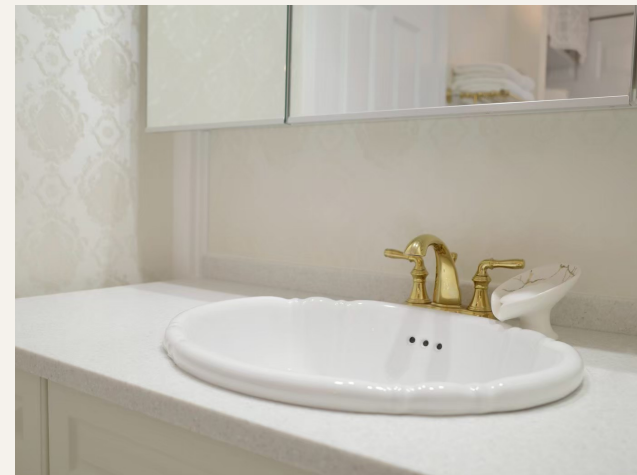
水栓・洗面 ゴールドの水栓金具と造作洗面化粧台
